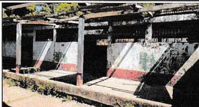
Foto 1: Cubierta de lámina en mal estado, foto tomada en el corredor del salón 5, necesita lámina nueva.
